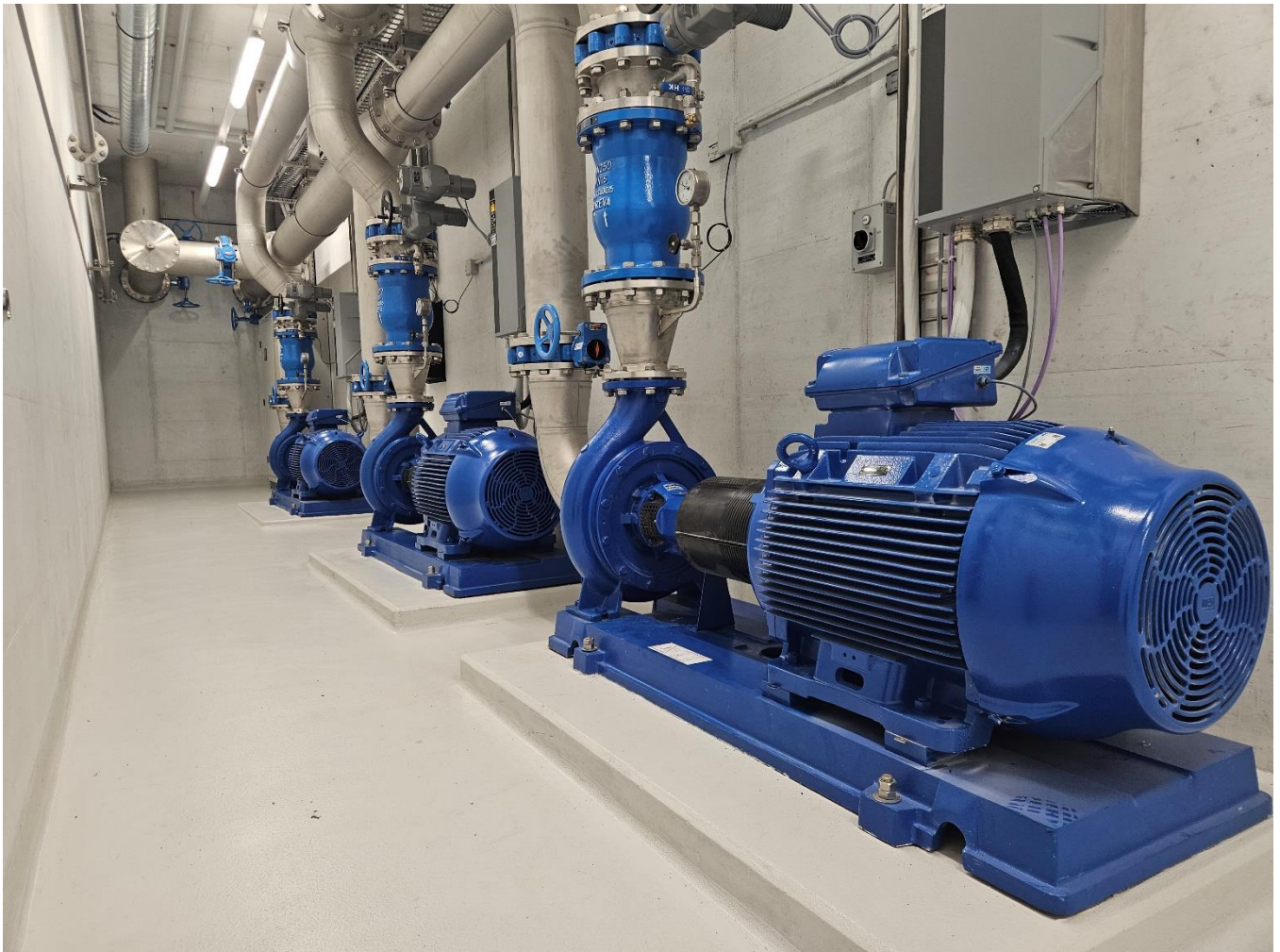
Abb. 12: Rohwasser-Pumpwerk der TWA
