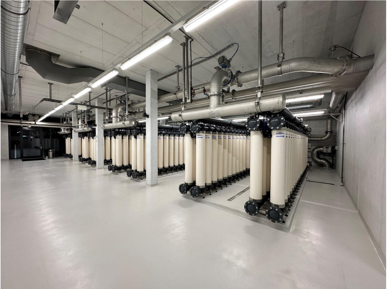
Abb. 9: Die Ultrafiltrations-Stufe der TWA. Hier wird die zuvor zugesetzte Pulver-Aktivkohle wieder abgetrennt
