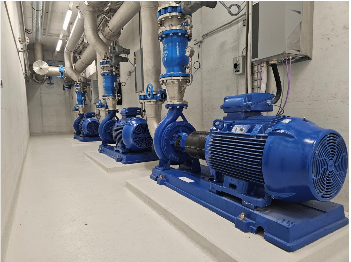
Abb. 12: Rohwasser-Pumpwerk der TWA
